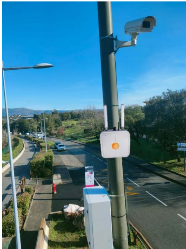
FIGURE 1 : LE SYSTEME D'INFORMATION CONSISTE EN UNE CAMERA FIXEE A UN MAT ORIENTE VERS LES EMPLACEMENTS DE STATIONNEMENT EN BORDURE DE VOIE, ICI A BIOT SUR L'AVENUE ROUMANILLE. LA CAMERA EST RELIEE A L'UNITE DE TRAITEMENT VIDEO PROTEGEE DANS UN BOITIER ETANCHE. POUR LA COMMUNICATION, UNE UNITE DE BORD DE ROUTE EST AUSSI CONNECTEE A L'UNITE DE TRAITEMENT (AJOUTEE ENSUITE SUR L'IMAGE).
